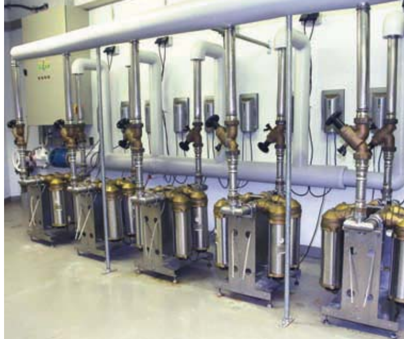
Als Kalkschutz des Plattenwärmetauscher-Systems wurden Geräte der Serie Permasolvent-Primus eingesetzt. Insgesamt 20 Wirkeinheiten werden für einen Volumenstrom von 660 l/min benötigt.
