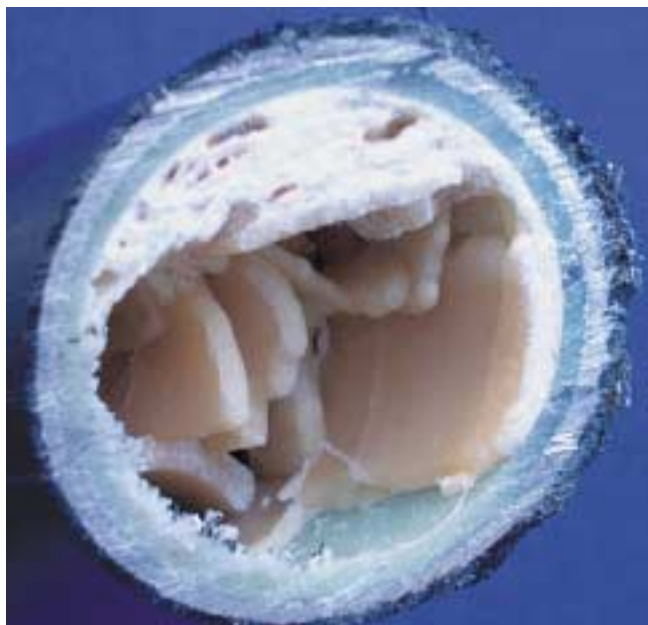
Infarktartiger Rohrverschluss in einem Kunststoffrohr, verursacht durch abgeplatzte Beläge, die anschließend verkleben.
