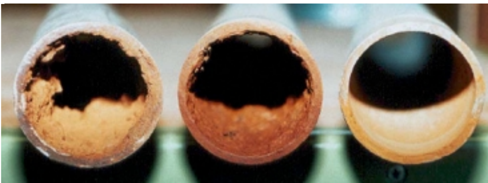
Das Bild zeigt links das Kaltwasserrohr unbehandelt, in der Mitte das Kaltwasserrohr nach einer Behandlung mit den permanentmagnetischen Wasserbehandlungssystemen und rechts das im Februar 2001 neu installierte Kontrollrohr mit einer homogen ausgebildeten Schutzschicht.
