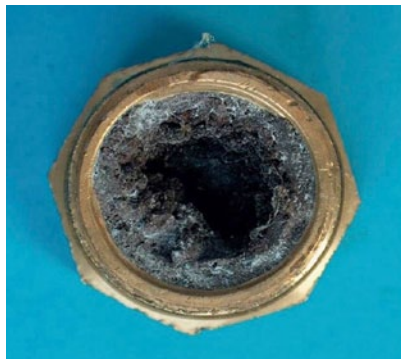
Verschluss im Anschlussbereich eines kathodisch geschützten Trinkwasserspeicherbehälters. Der dunkle Belag besteht vorwiegend aus Kalziumkarbonat mit eingelagertem Kupfer, welches die Ablagerung elektrisch leitend hält.
