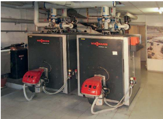
Bild 4 • Ergänzend zum Blockheizkraftwerk gibt es zudem zwei Öl-Heizkessel mit jeweils 600 KW.
