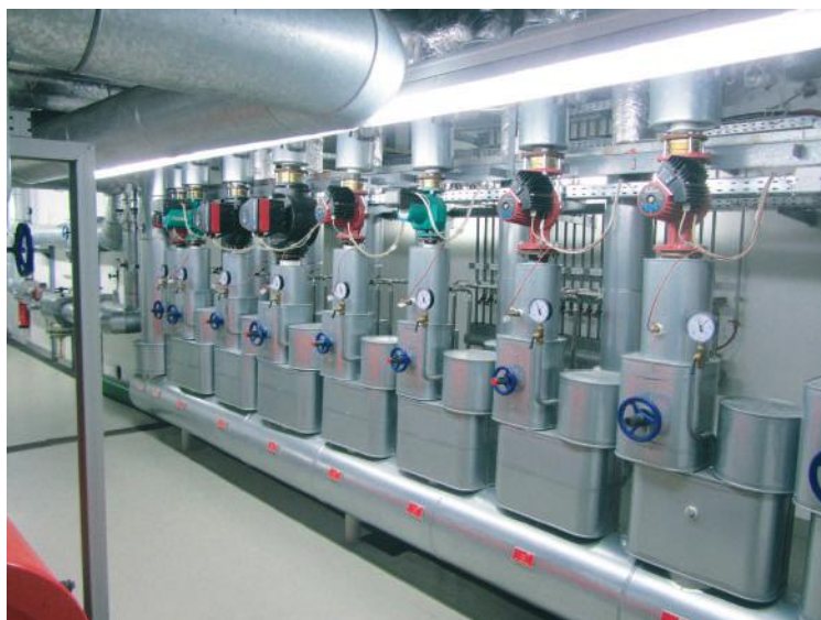
Bild 3 • Ein Blick in den Heizraum mit dem Heizungsverteiler: Dank der Inline-Entsalmethode permaLine PT-IL 20 lassen sich selbst weit verzweigte und komplexe Füllwasseraufbereitungen einfach umsetzen.
