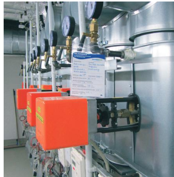
Bild 6 • Damit alles seine Ordnung hat, werden die Messwerte anschließend im Anlagenbuch dokumentiert.
