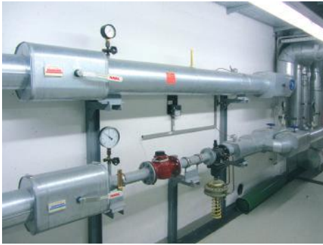
Bild 2 • Das Bundesverfassungsgericht besteht aus mehreren Gebäudekomplexen, die via Fernheizung über zwei Wärmetauscher mit 400 kW und 800 kW Leistung beheizt werden.
