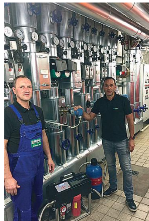
Thomas Gerold (links) und permatrade Wasserexperte Uwe Flechsig bei der Heizungswasseraufbereitung: permaLine lässt sich mit wenigen Handgriffen einfach und sicher ins Heizsystem einbinden und arbeitet anschließend bei laufendem Betrieb selbstständig weiter. (Fotos: Das Tegernsee/ Permatrade)
