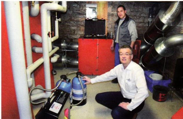
Bild 2 Joachim Mönikheim (vorne) und Obermonteur Thomas Weinmann binden PT-IL 20 mit wenigen Handgriffen ins Heizsystem ein. So bald die erforderlichen Einstellungen vorgenommen worden sind, arbeitet das System weitgehend automatisch – und kann auch einfach über Nacht weiterlaufen
