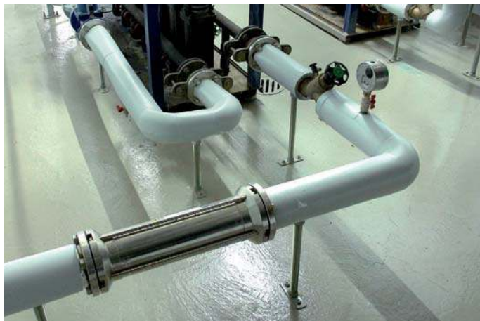
Für einen optimalen Korrosionsschutz installierte perma-trade die Geräte der Serie permasolvent aktiv in den Kalt- und Warmwasserleitungen der beiden Druckzonen.
