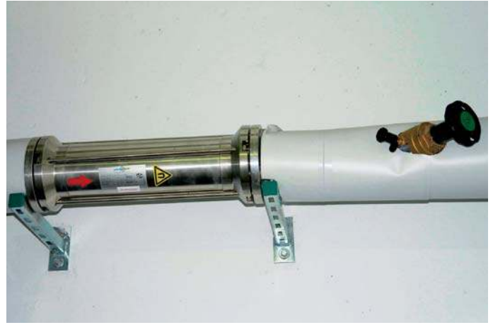
Pro Druckzone besteht das Korrosionsschutzpaket permasolvent aktiv aus jeweils einem Gerät des Typs PT-S 50 EF im Kaltwasserzulauf sowie einem PT-S 40 EFW in der Warmwasserleitung.
